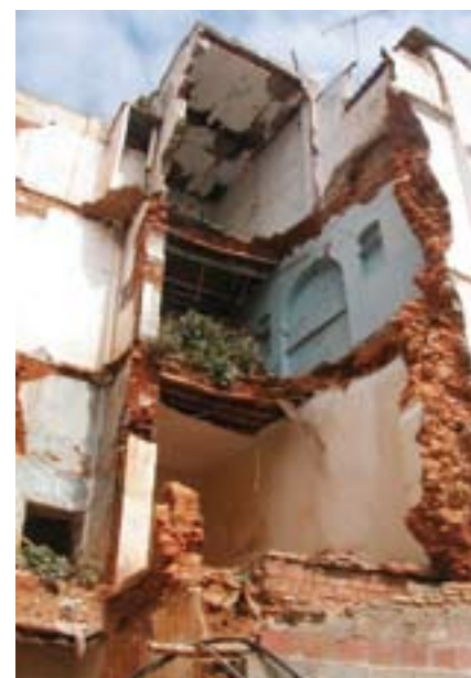
Chaque édifice qui s'écroule fragilise le voisin. Les interventions sont urgentes
